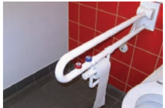
SCHULE IN DER STEINBREITE STÜTZGRIFF MIT SPÜHLUNG UND NOTRUF
