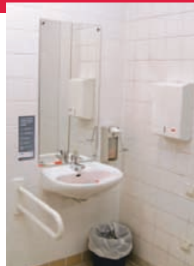
IGS RODERBRUCH, SPORTHALLE HANDWASCHBECKEN
