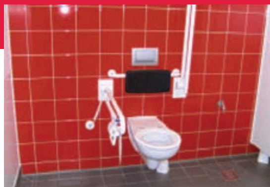
SCHULE IN DER STEINBREITE WC-SITZ MIT BEIDSEITIGEM FREIRAUM UND KLAPPBAREN STÜTZGRIFFEN MIT SPÜHLUNG UND NOTRUF
