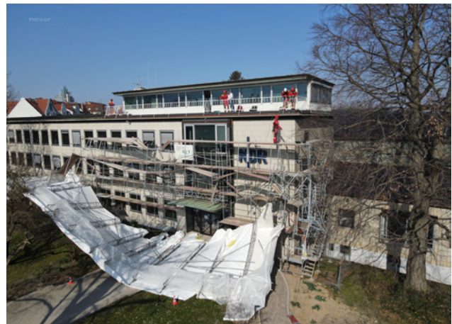
Die SRHT sichert das umgestürzte Gerüst
