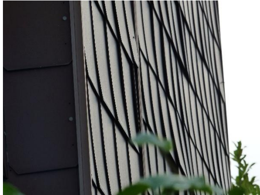
Abb. 20 Schindeln an der Westseite des nordwestlichen Gebäudes des ehemaligen Wertstoffhofes.
