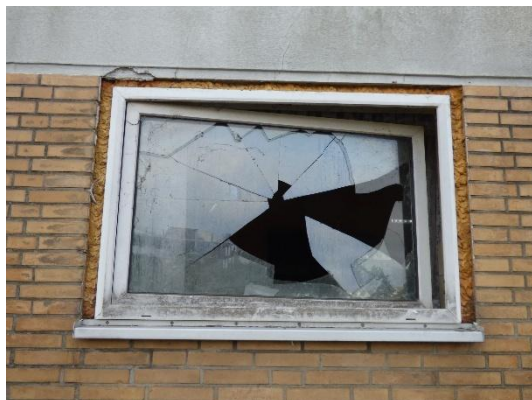
Abb. 21 Defektes Fenster an der Nordseite eines Gebäudes des ehemaligen Wertstoffhofes.
