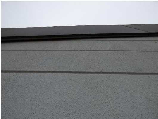
Abb. 16 Spalte an der nördlichen Fassade des ehemaligen Lebensmittelmarktes.
