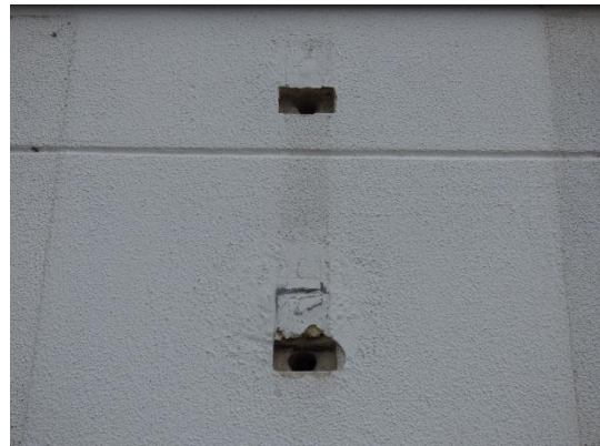
Abb. 17 Löcher an der westlichen Fassade des ehemaligen Lebensmittelmarktes.
