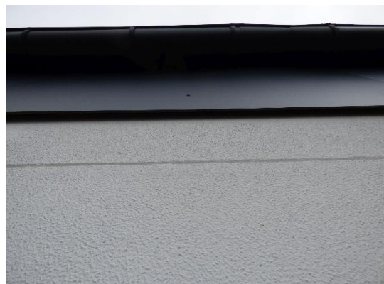
Abb. 19 Spalte an der westlichen Fassade des ehemaligen Lebensmittelmarktes.
