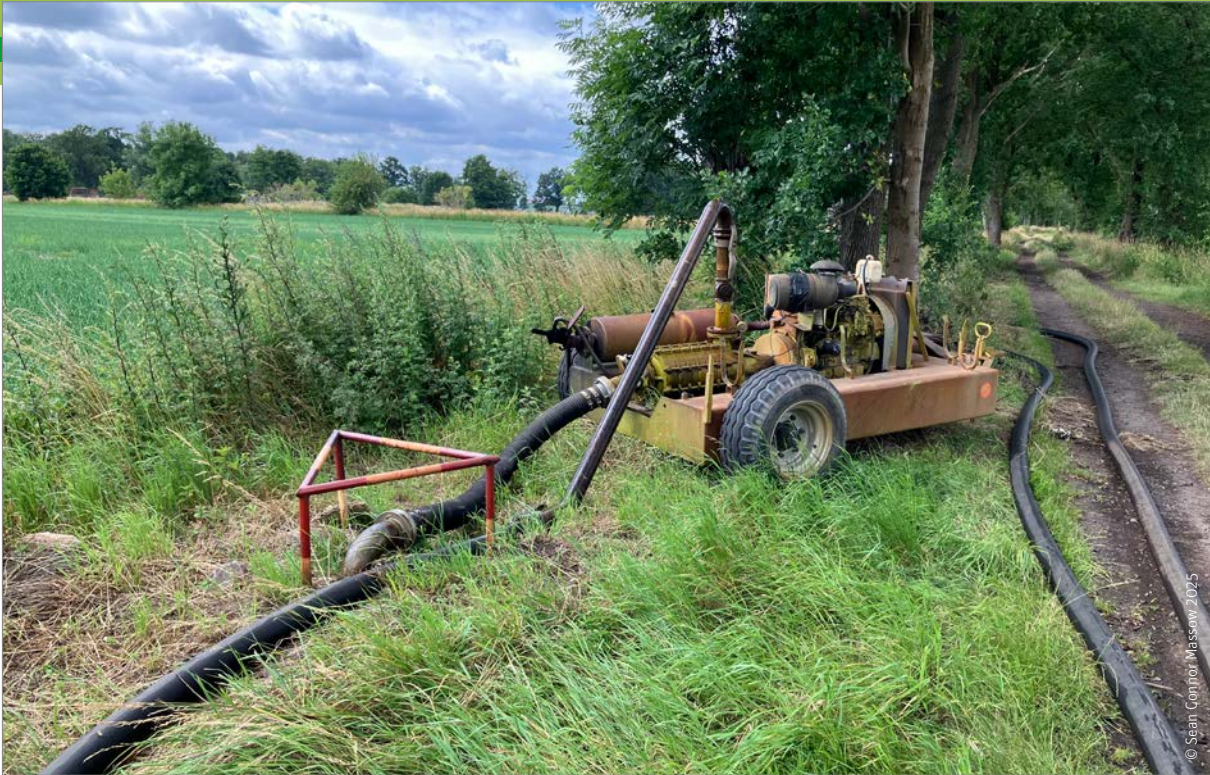
Beispiel eines Beregnungsbrunnens mit angeschlossenem Aggregat (Pumpe)
