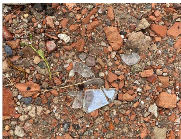
Sichtbare Glasscherben in der Deckschicht
