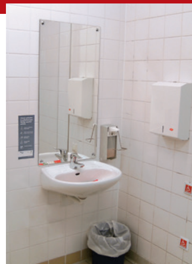
IGS RODERBRUCH, SPORTHALLE HANDWASCHBECKEN
