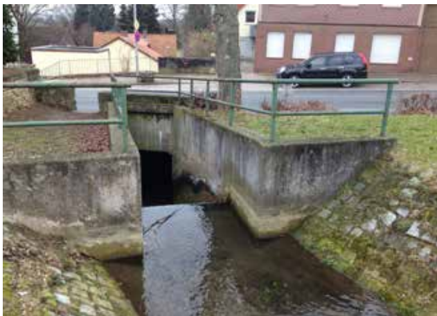
Straßen-Unterquerung (L 461) des neuen Gehlenbachs in Eldagsen
