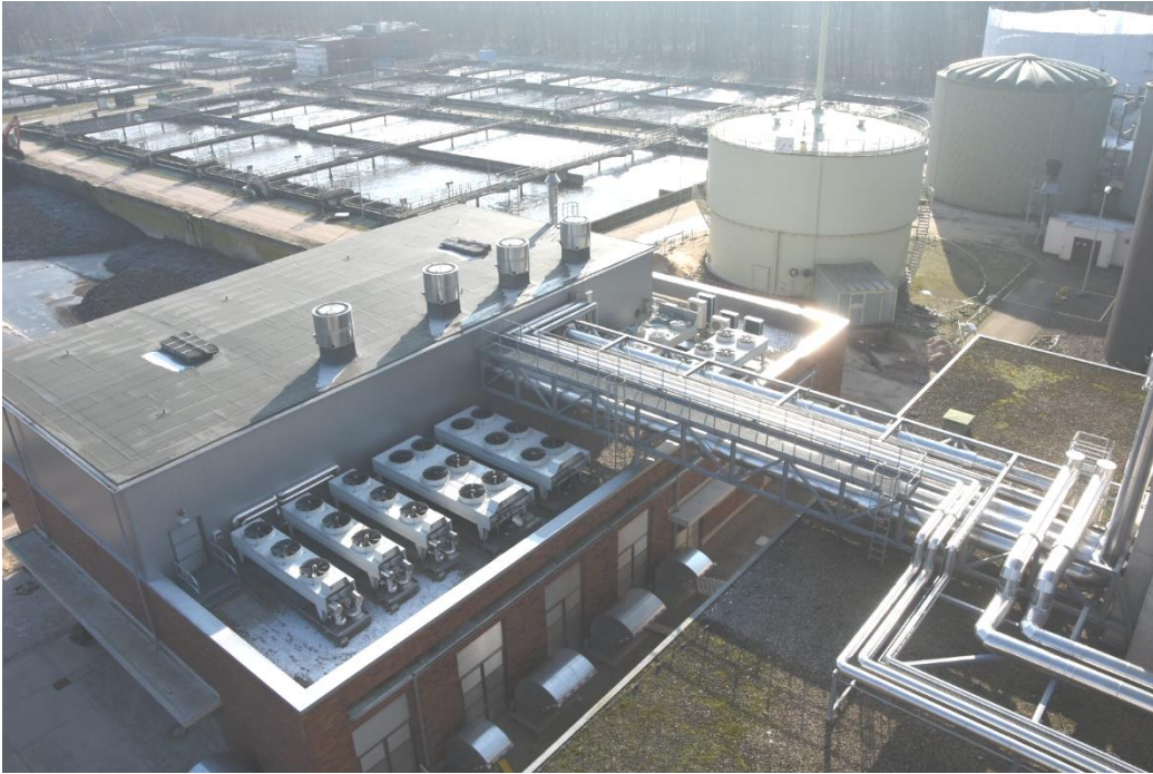
2018: Das Blockheizkraftwerk Gümmerwald von oben, deutlich erkennbar auch die neuen Rohrleitungen
