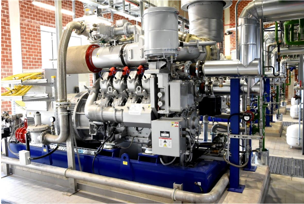
Einer der V8-Zylinder-Gasmotoren in der neuen Maschinenhalle
